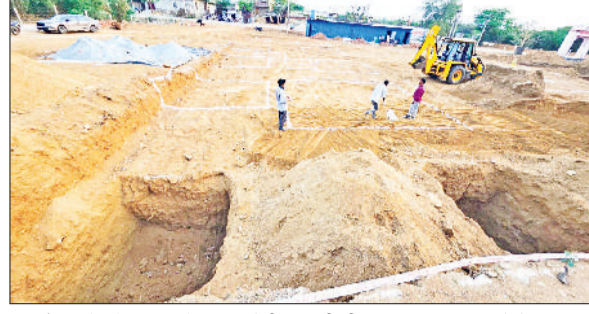
नारनौल। रोप वे निर्माण के लिए खोदी जा रही नींव। फोटो: हरिभूमि
